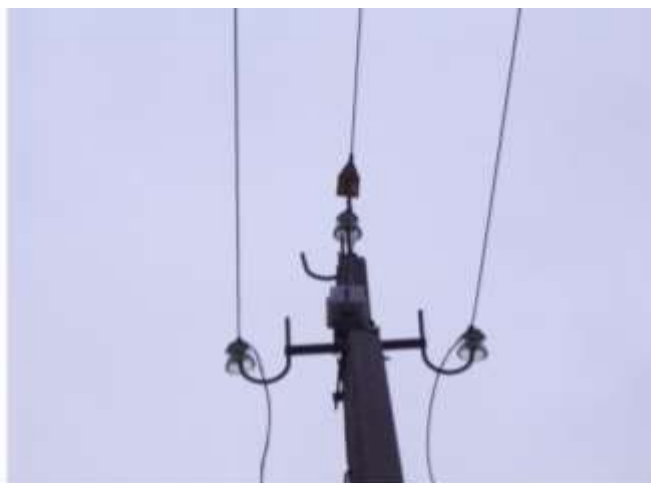
Рис. 3. Электронный блок передающего устройства ФИНКЗ и подвешенный к фазному проводу высоковольтный резистор
