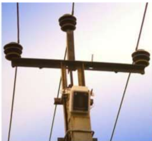
Рис.1. Установка ИКЗ-1 фирмы Антракс на высоковольтной опоре
